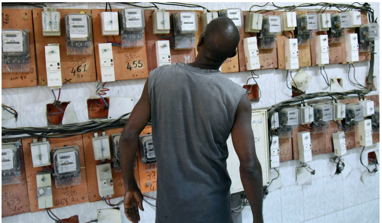
Compteurs électriques à Abidjan, Côte d'Ivoire. Photo : Getty/Sia-Kambou
